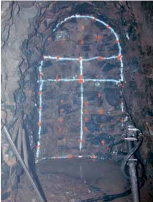
Fig. 2. Shotfired tunnel in an old gravity-wall dam. Bild 2. Sprengvortrieb in einer alten Schwergewichtsmauer einer Talsperrenanlage. Source / Quelle: Spreng- und Erschütterungssachverständigenbüro Dipl.-Ing. Josef Hellmann, Dortmund
