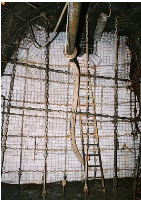
Fig. 11. Partition system in the Buchholz drift Bild 11. Trennwand in der Wetterstrecke Buchholz
