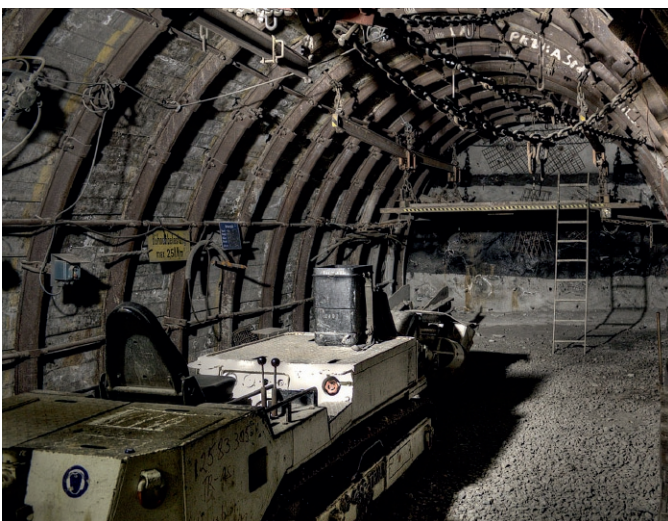
Fig. 9. Training roadway at TZB Recklinghausen. Bild 9. Ausbildungsstrecke im TZB Recklinghausen. Photo/Foto: von Hartlieb
