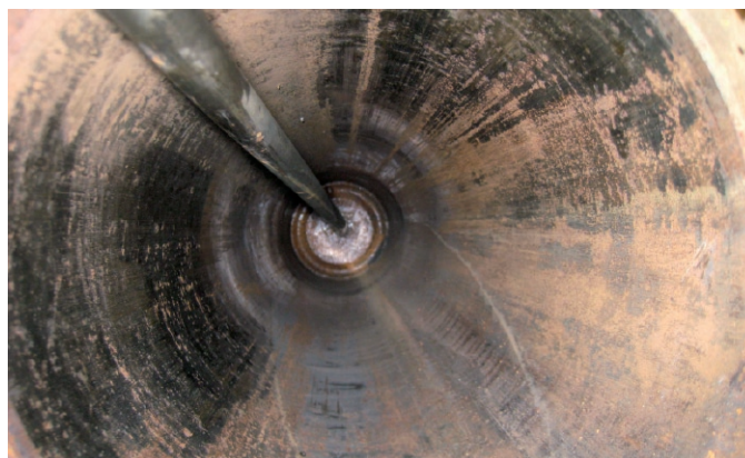
Fig. 2. Shifting ram opened, cause of failure: Corrosion of the running surface. Bild 2. Schreitzyylinder geöffnet, Ausfallursache: Korrosion der Lauffläche.
