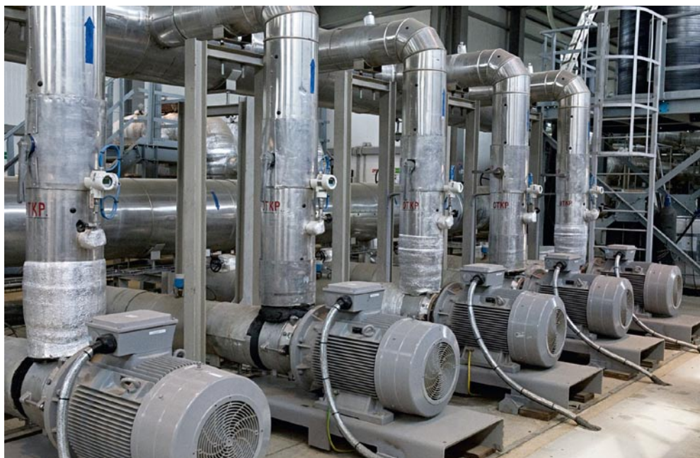
Fig. 2. Brine pumps for shaft freezing at the Usolski Combine potash mine in the Perm region Bild 2. Solepumpen zum Gefrieren der Schächte des Kalisalzbergwerks Usolski Kali-Kombinat in der Perm-Region
