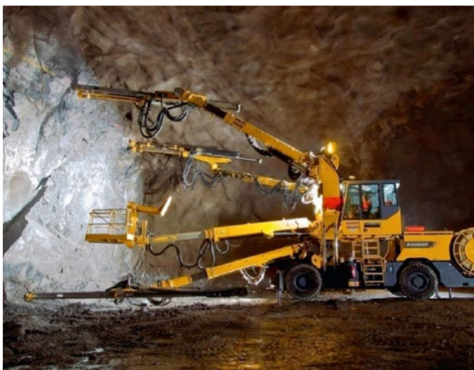
Fig. 7. Boomer XE 4 drill jumbo with four booms and service basket Bild 7. Bohrwagen Boomer XE 4 mit 4 Bohrarmen und Ladekorb Photo / Foto: Atlas Copco
