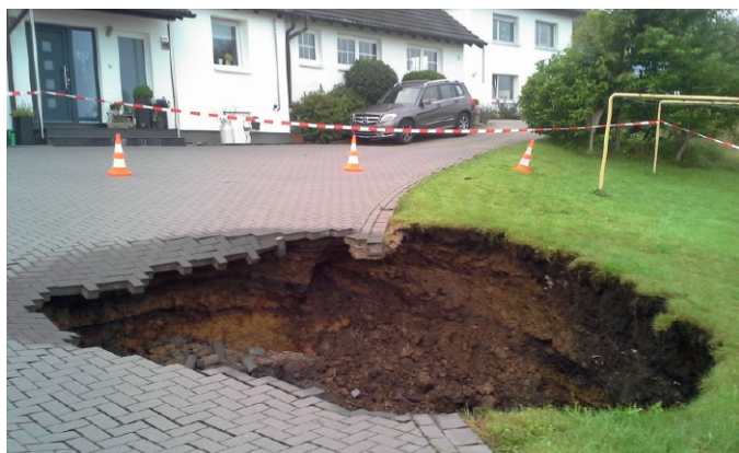
Fig. 2. Surface collapse at Witten, Speckbahn 15, in 2015. Bild 2. Tagesbruch in Witten, Speckbahn 15, im Jahr 2015.
