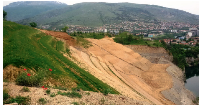
Fig. 8. Northern slope area with drains and berm (05/2015). Bild 8. Nördlicher Hangbereich mit Gräben und Berme (05/2015).
