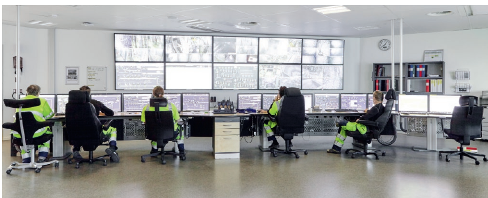
Fig. 4. Garpenberg: Central control room with ABB's System 800xA. Bild 4. Garpenberg: Zentrale Warte mit System 800xA von ABB. Source/Quelle: ABB
