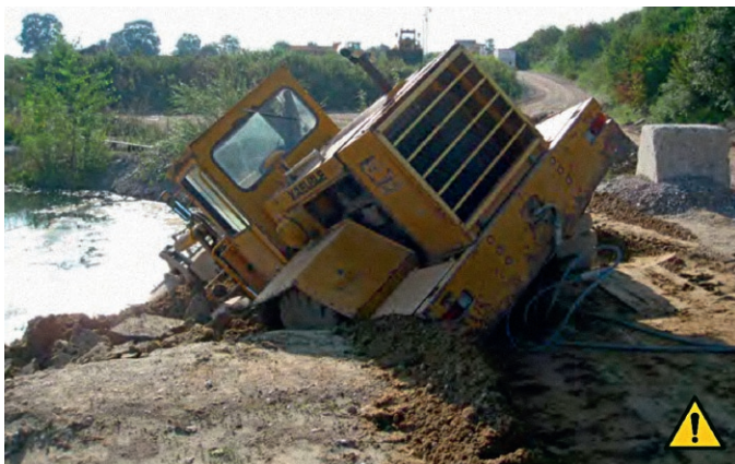
Fig. 1. Caving-in of a wheel loader (1). Bild 1. Einsinken eines Radladers (1).
