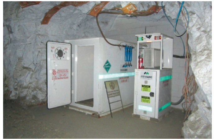
Fig. 2. Outside view of a built-in-place shelter with external battery power supply and air conditioning. Bild 2. Außenansicht einer stationären Fluchtkammer mit externer Batteriestromversorgung und Klimatisierung. Photo/Foto: Brune
