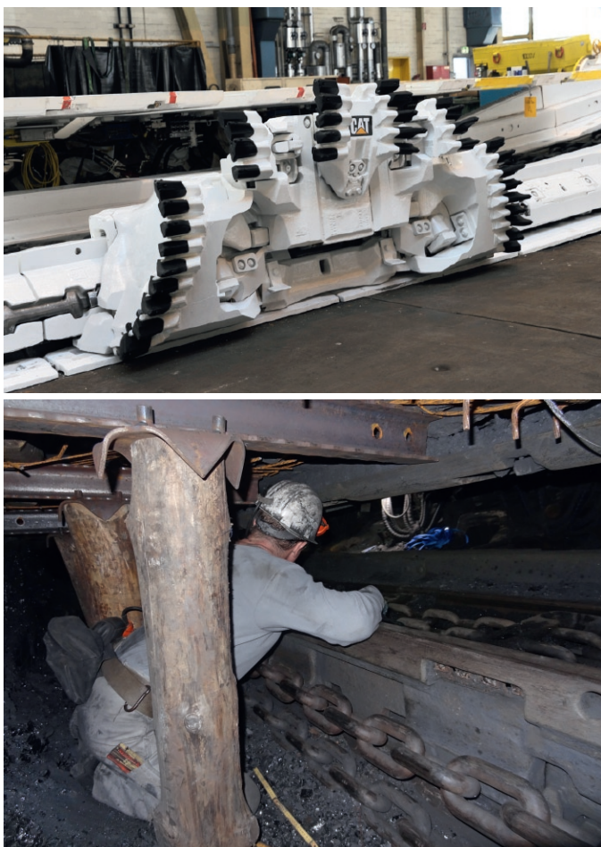
Fig. 5. Plow GH 800, installation plow guide. Bild 5. Hobelanlage GH 800, Einbau Hobelführung. Photos/Fotos: RAG Anthrazit Ibbenbüren GmbH
