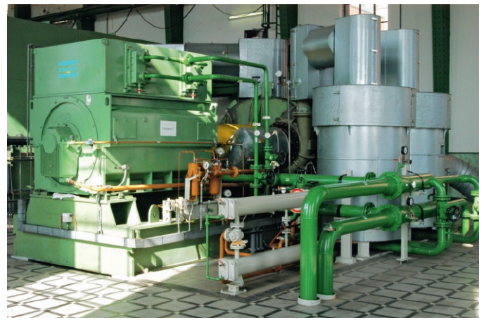
Fig. 3. Electric compressor gas extraction in the EVA. Bild 3. Elektrokompessor Gasabsaugung in der EVA. Source/Quelle: RAG Anthrazit Ibbenbüren GmbH
