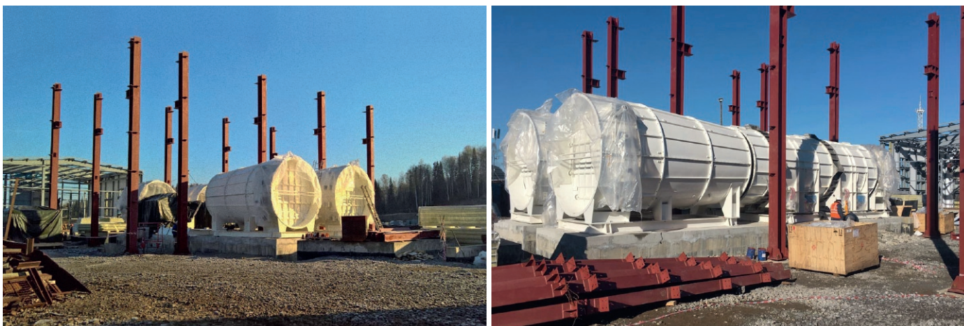
Fig. 5/6. Assembly of the main mine fan at the mine. // Bild 5/6. Montage des Hauptgrubenlüfters auf dem Bergwerk. Source/Quelle: CFT
