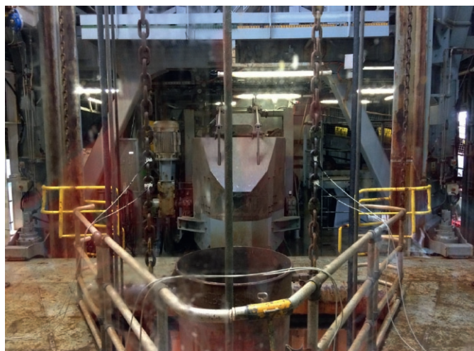
Fig. 6. Measurement chain at the mouth of the downpipe. Bild 6. Messkette Einlauf Fallrohr. Photo/Foto: THIELE
