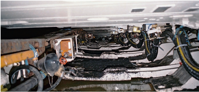
Fig. 12. Roof support Group 0 first used in the mining section 16/17 West seam 48. // Bild 12. Schildausbau Gruppe 0 Ersteinsatz in der Bauhöhe 16/17 Westen Flöz 48.
