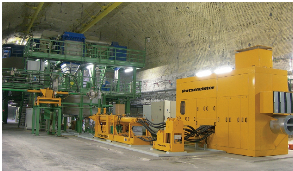
Fig. 16. Pumping facility for underground recovery plant in Unterbreizbach/Germany. // Bild 16. Pumpstation für den Versatz unter Tage auf dem Bergwerk Unterbreizbach.
