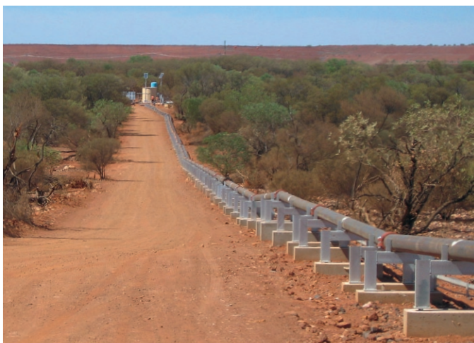
Fig. 3. Delivery line to site of placement of backfill material. Bild 3. Horizontale Förderleitung.
