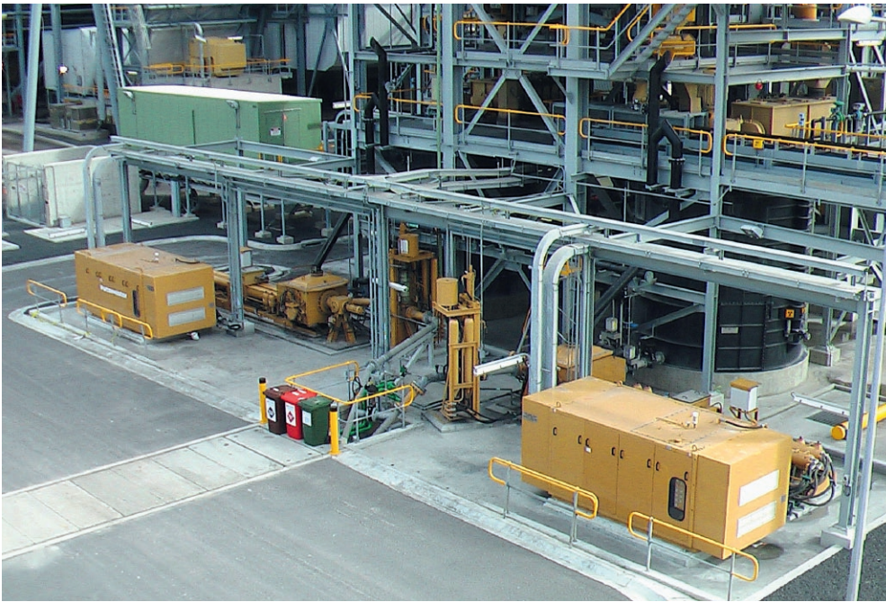
Fig. 17. Redundant ash preparation and pumping plant at Kogan Creek. Bild 17. Herstellung einer pumpfähigen Suspension mit Kraftwerksasche im Kohlekraftwerk Kogan Creek, einschließlich Pumpeinheit und Redundanz.
