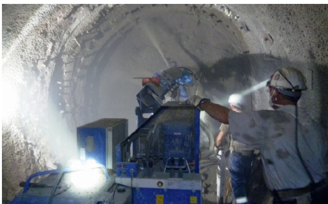
Fig. 8. Shotcrete manipulator Type Meyco Oruga. Bild 8. Spritzbetonmanipulator Typ Oruga, Firma Meyco. Photo/Foto: www.epircoc.com
