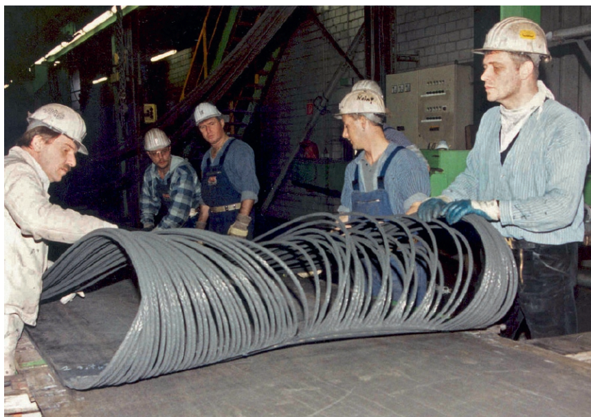
Fig. 3. Work under way on the belt conveyor. // Bild 3. Arbeiten am Fördergurt. Photo/Foto: RAG
