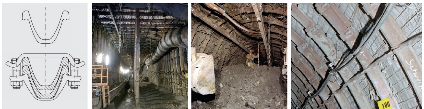
Fig. 8. Yielding standing support with TH-profile. // Bild 8. Nachgiebiger Ausbau aus TH-Profilträgern.
