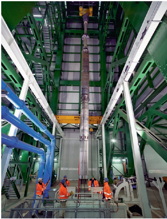
Fig. 3. Submersible centrifugal pump at Walsum Central Dewatering Station. // Bild 3. Tauchmotorkreiselpumpe Zentralwasserhaltung Walsum. Photo/Foto: RAG
