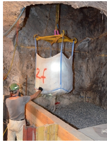
Fig. 6. Unloading of gravel for the construction of an abutment sealing element with bitumen. // Bild 6. Einbau des Schotters zur Herstellung eines kombinierten Widerlager-Dichtelements mit Bitumen. Photo/Foto: BGE mbH
