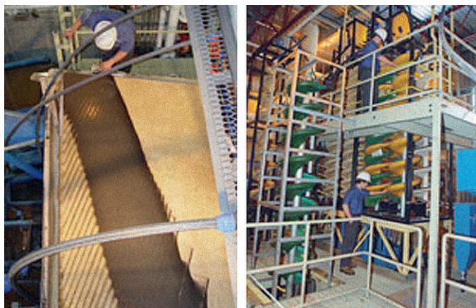
Fig. 6. IHC Robbins oil sands tailings pilot plant to recover Ti-Zr minerals (11). // Bild 6. IHC Robbins Pilotanlage zur Rückgewinnung von Ti-Zr aus Ölsand-Tailings (11).
