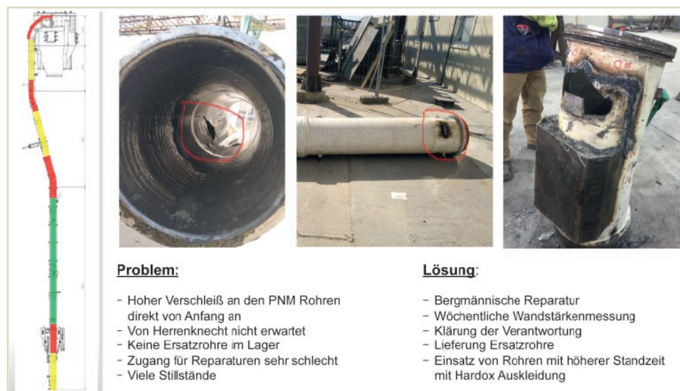
Fig. 8. Visible wear at the PNM pipe. // Bild 8. Starker Verschleiß an der Saugleitung. Source/Quelle: Redpath Deilmann
