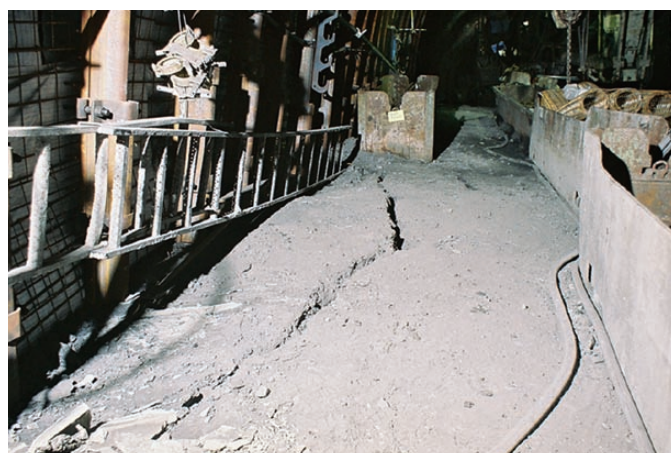
Fig. 9. Roadway in a seam: Raised floor, from which a big gas volume flowed in (June 2007: 2,200 m 3 ). // Bild 9. Abbaubegleitstrecke in einem Flöz: Aufgebrochenes Liegendes, aus dem eine große Gasmenge zuströmte (Juni 2007: 2.200 m 3 ). Photo/Foto DMT
