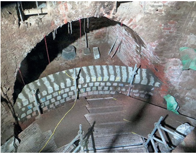
Fig. 8. Concreting the shaft sump at a depth of 1,230 m. Bild 8. Betonierung des ehemaligen Pumpenorts in 1.230 m Teufe. Photo/Foto: BGE
