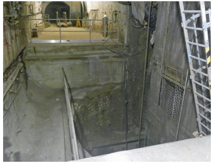
Fig. 9. Konrad 1 shaft, level 5, shaft landing after removing the old shaft floor frame. // Bild 9. Schacht Konrad 1, Anschlag 5. Sohle nach Ausbau des alten Schachtstuhls. Photo/Foto: BGE
