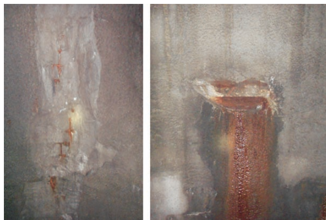
Fig. 2. Damaged shotcrete lining. // Bild 2. Schäden am Spritzbetonausbau. Photos/Fotos: Redpath Deilmann
