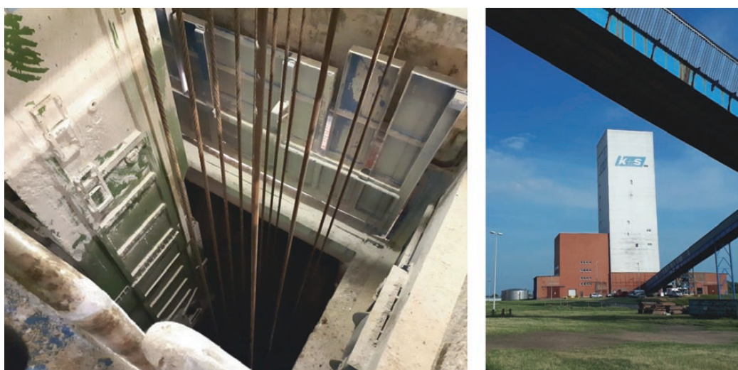
Fig. 5. Zielitz 1 shaft – headframe and view into the shaft from the surface. // Bild 5. Schacht Zielitz 1 – Förderturm und Blick in den Schacht von der Rasenhängebank. Photos/Fotos: Redpath Deilmann
