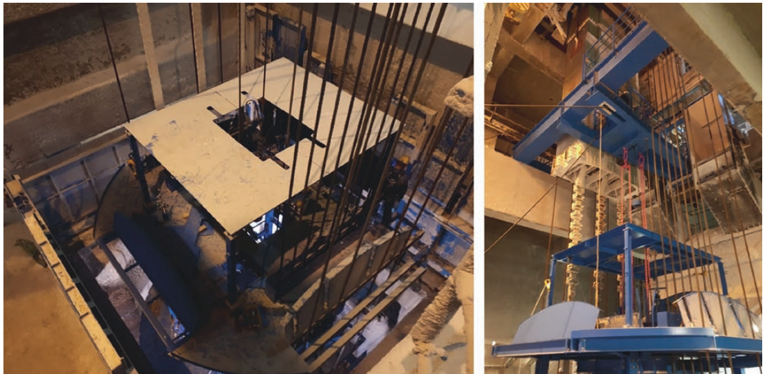
Fig. 6. Mobile platform between the conveying and guiding ropes at the surface. // Bild 6. Verfahrbare Arbeitsbühne zwischen den Seilen im Schacht an der Rasenhängebank. Photos/Fotos: Redpath Deilmann
