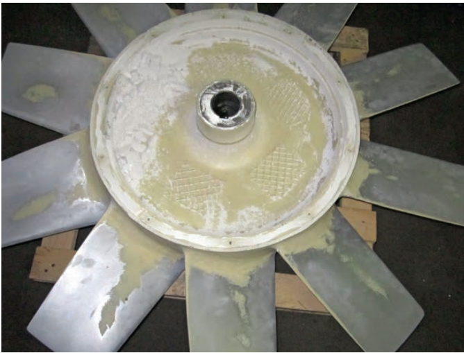
Fig. 8. Dust deposits on the impeller. // Bild 8. Staubablagerungen auf dem Flügelrad. Photo/Foto: Korfmann
