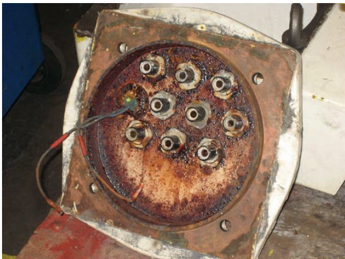
Fig. 14. Chemical reaction inside the housing. // Bild 14. Chemische Reaktion im Gehäuseinneren. Photo/Foto: Korfmann
