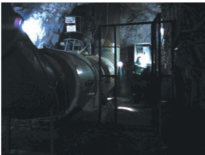
Fig. 9. Fan location. // Bild 9. Lüfterstandort. Photo/Foto: Korfmann
