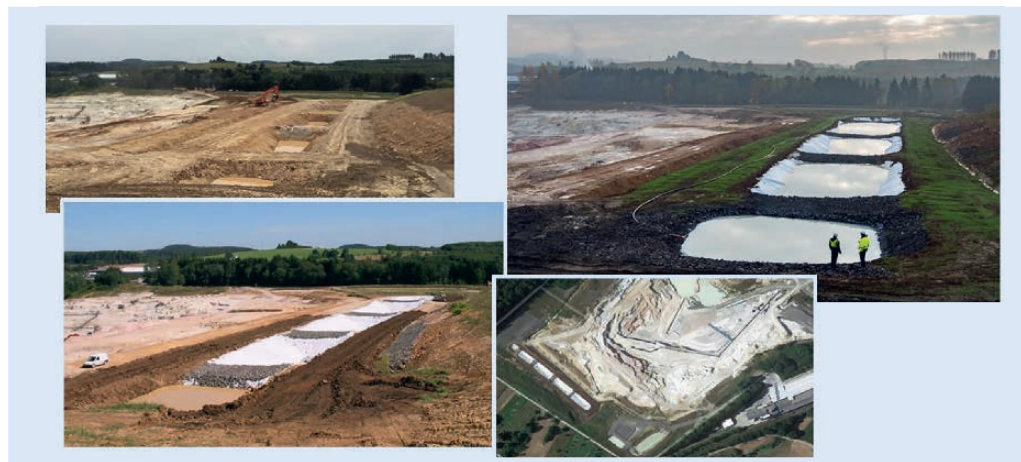
Fig. 1. Series fo clarifiers at the Petschmorgen plant. Bild 1. Klärbeckenreihe im Betrieb Petschmorgen. Photos/Fotos: Sibelco
