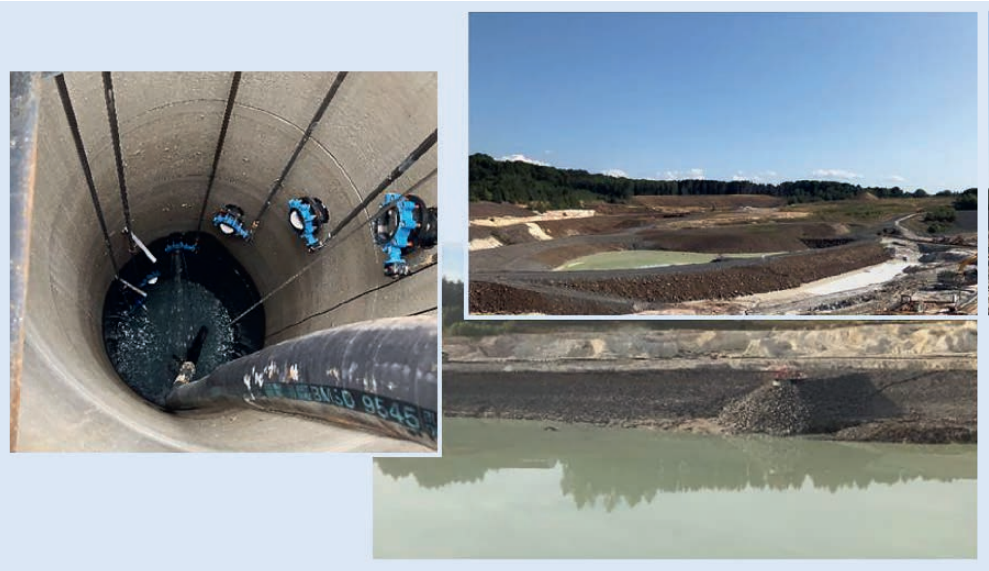
Fig. 5 R-basin with water shaft drainage system. // Bild 5. R-Becken mit Wasserschacht – Ablass-Entleer-System. Photos/Fotos: Sibelco
