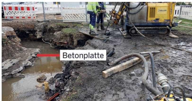
Fig. 5. Drilling operations and concrete slab encountered. // Bild 5. Bohrarbeiten und angetroffene Betonplatte. Photo/Foto: Fichtner Mining & Environment GmbH
