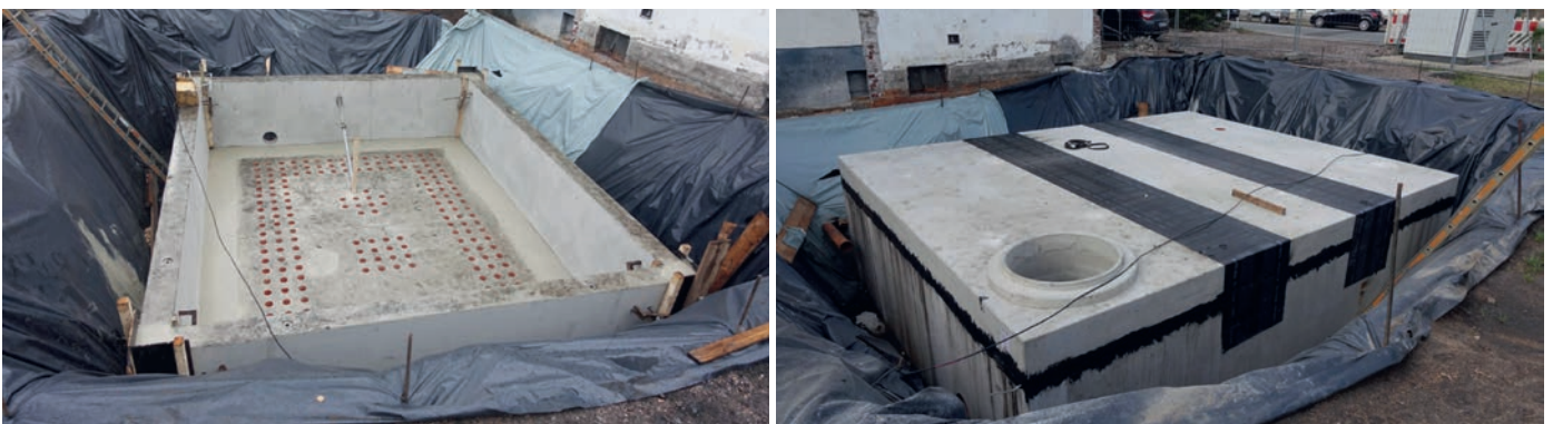
Fig. 8. Completed concreting of the floor slab and walls (l.) and the drainage structure (r.). // Bild 8. Fertiggestellte Betonierung der Bodenplatte und der Wände (l.) sowie des Drainagebauwerks (r.). Photos/Fotos: Fichtner Mining & Environment GmbH
