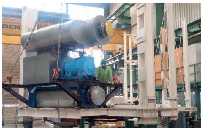
Fig. 5. PNM blowers with noise protection in the plant. Bild 5. PNM-Gebläse mit Schallschutz im Werk. Source/Quelle: Redpath Deilmann
