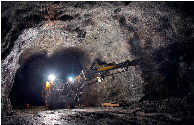
Fig. 5. Drilling rig underground in LKAB's Malmberget mine in Sweden. Bild 5. Bohrwagen im LKAB-Bergwerk Malmberget in Schweden. Photo/Foto: LKAB
