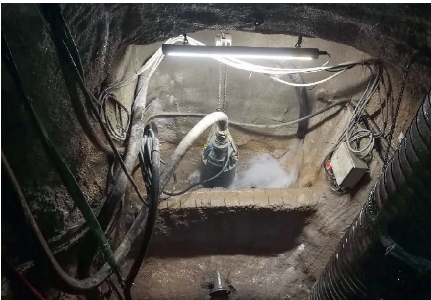
Fig. 4. Pump chamber in the shaft. // Bild 4. Pumpenkammer im Schacht. Photo/Foto: SME
