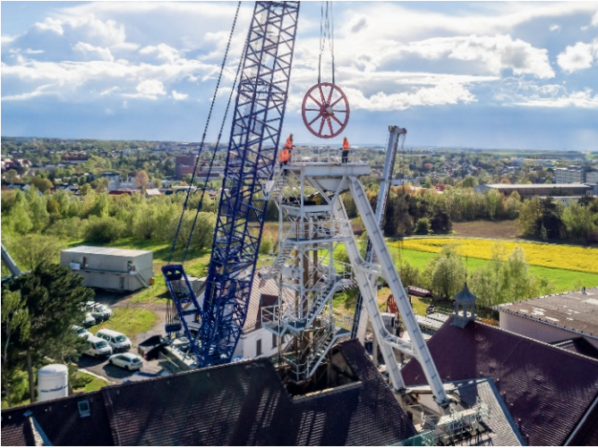
Fig. 2. Removing of the rope sheaves on the head frame. // Bild 2. Herausheben der Seilscheiben am Fördergerüst. Photo/Foto: Kerstin Rysavy
