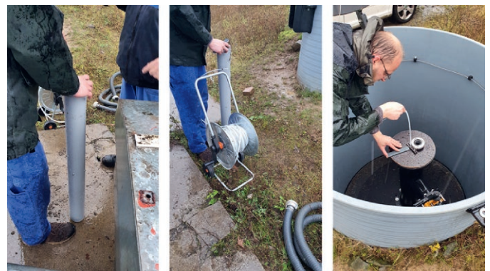
Fig. 4. Determination of gas velocities over the depth of a vertical gas well at different applied volume flow rates and a characteristic flow profile. Bild 4. Bestimmung der Gasgeschwindigkeiten über die Tiefe eines Vertikalgasbrunnens bei unterschiedlichen angesetzten Volumenströmen und ein charakteristisches Strömungsprofil. Source/Quelle: CDMS 2022
