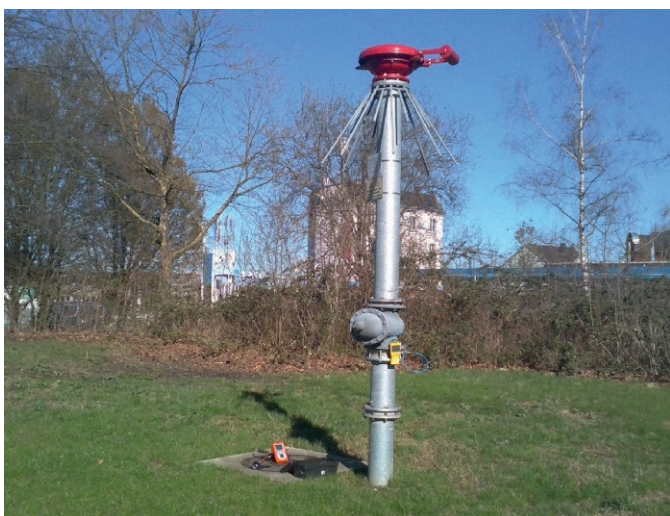
Fig. 2. Degassing pipe at Constantin 1 shaft. // Bild 2. Entgasungsleitung am Schacht Constantin 1. Photo/Foto: Bezirksregierung Arnsberg
