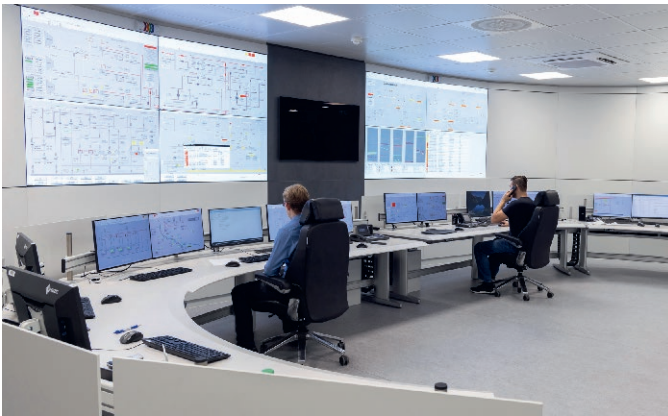
Fig. 4. Central control room Saarbrücken. Bild 4. Zentrale Warte Saarbrücken. Photo/Foto: Iqony
